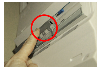
Automatsikringer er afkoblet og vippes op igen
