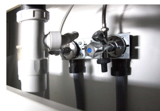
Vaskeskab med vand, afløb og el til opvaskemaskine
