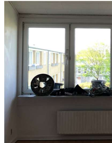
Loftshøjden er lav ved facade - og giver begrænsning ved efterisolering 'indad'.
