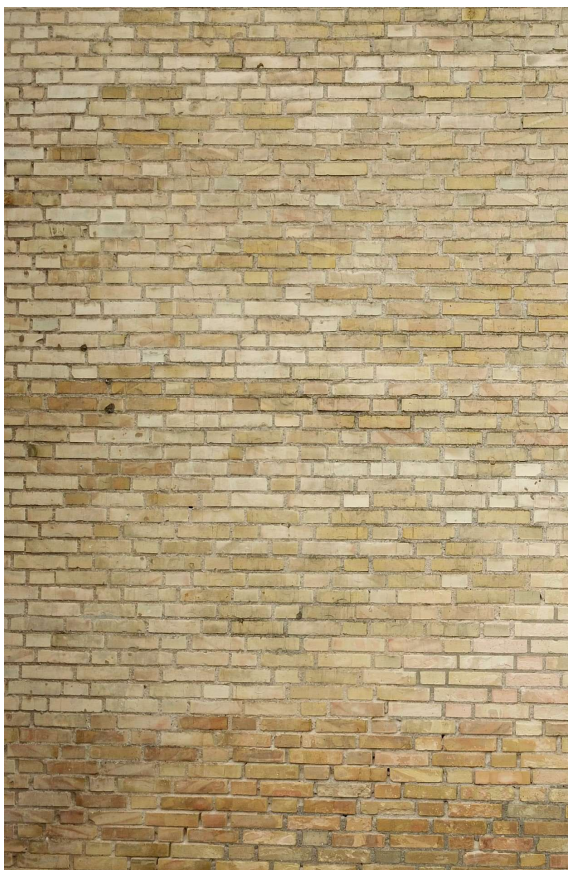
Eksempel på eksisterende murværk med opfugtning ved nederste del
