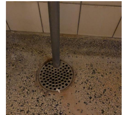
Ikke godkendte membranløsninger omkring afløb
