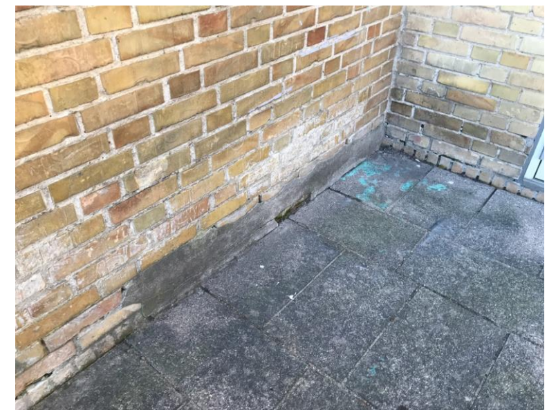
Eksempel på opfugtning af murværk ved sokkel
