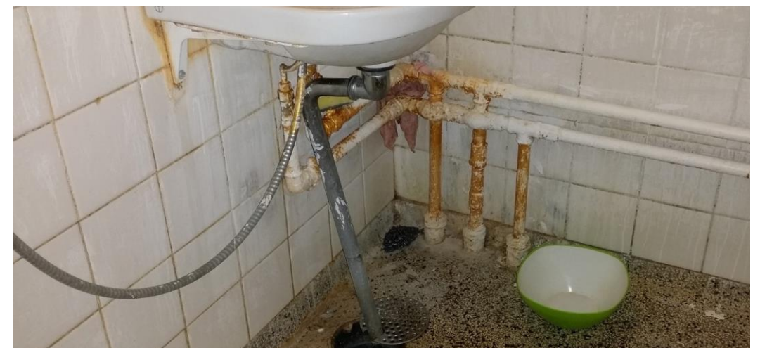
Rustangreb på vandør
