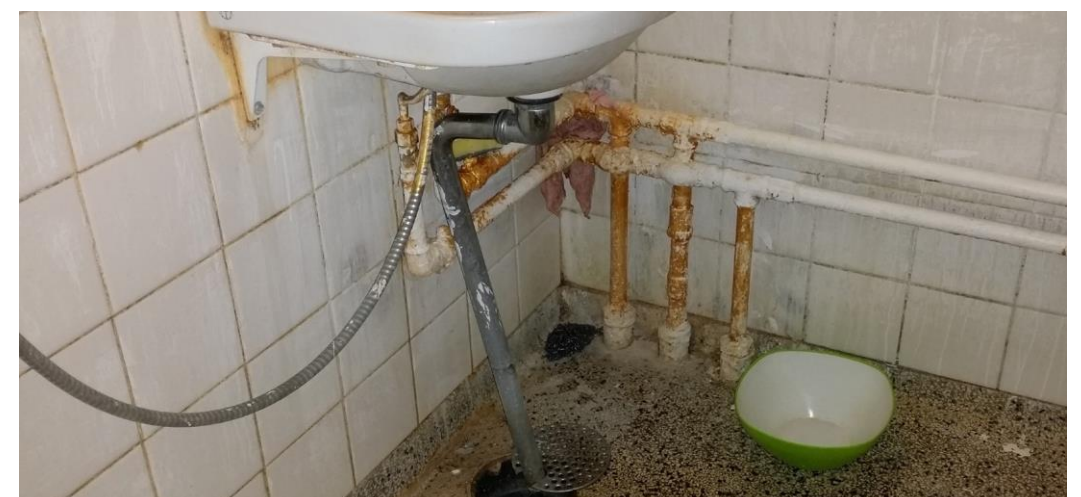
Rustangreb på vandrør
