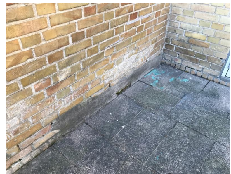
Eksempel på opfugtning af murværk ved sokkel
