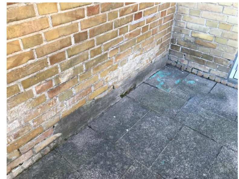
Eksempel på opfugtning af murværk ved sokkel
