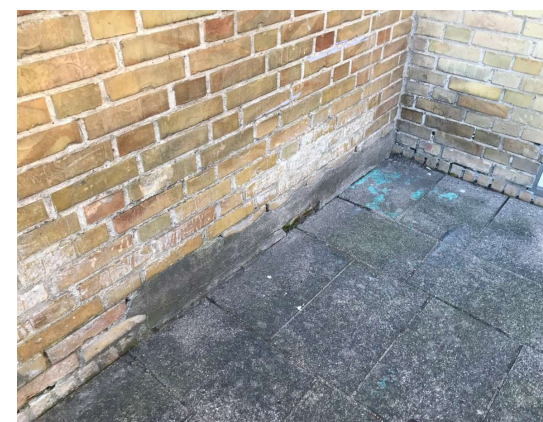
Eksempel på opfugtning af murværk ved sokkel
